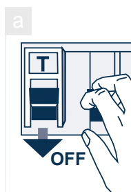
Couper l'alimentation électrique générale
